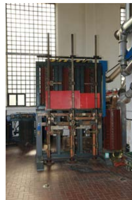
Area prove Forti Correnti – Zona prove cortocircuito.
